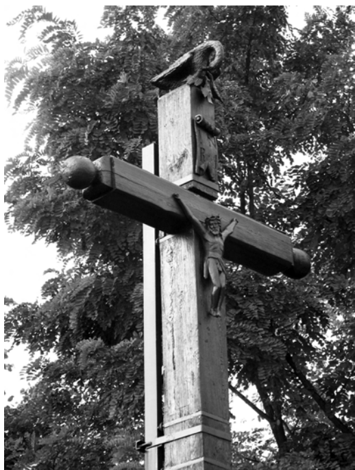
Ryc. 4. Konstrukcja stalowa w górnej części krzyża (fot. J. Wiśniewski) Fig. 4. Steel structure on the top of the cross (phot. J. Wiśniewski)
